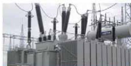
Эквадор: силовой трансформатор для CELEC S.A
