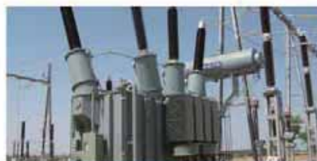
Буркина-Фасо: силовой трансформатор для Forclum
