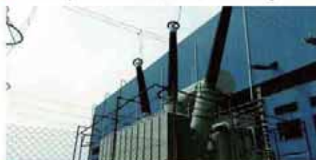
Индия: трансформатор 420kV 60MVA
