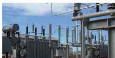
Австралия: трансформатор 132kV для ВНР
