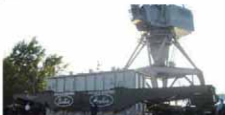
Сербия: трансформатор 400kV 400MVA
