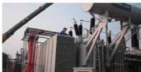
Бангладеш: силовой трансформатор для Aggreko
