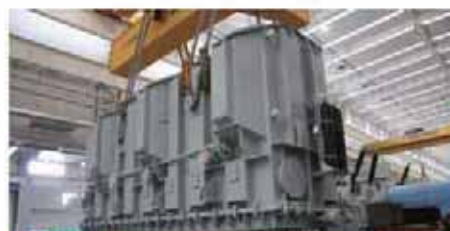
Пуэрто-Рико: трансформатор USA230kV 570MVA
